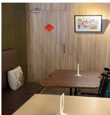
▲ 改造前(廁所的門與牆壁顏色相同，失智者難分辨此處是廁所)
